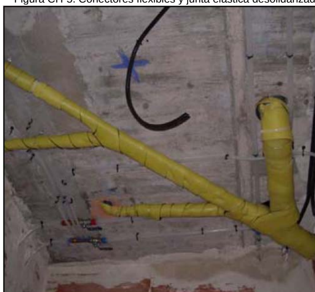
Figura CH-7. Aislamiento de pulpo de desagüe
