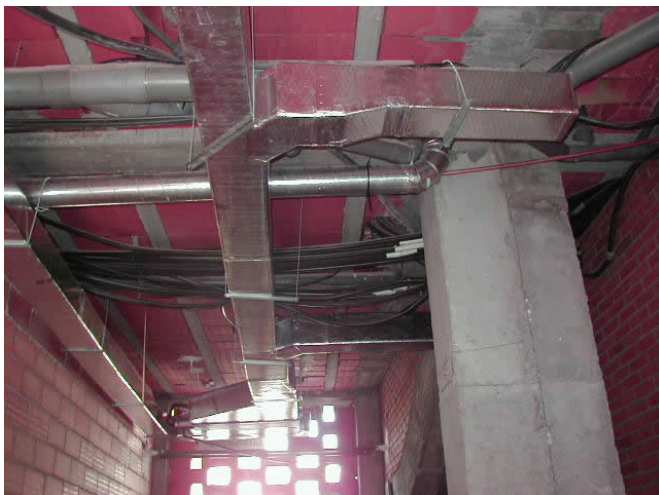
Figura CLI-03. Ejemplo de conductos de climatización
