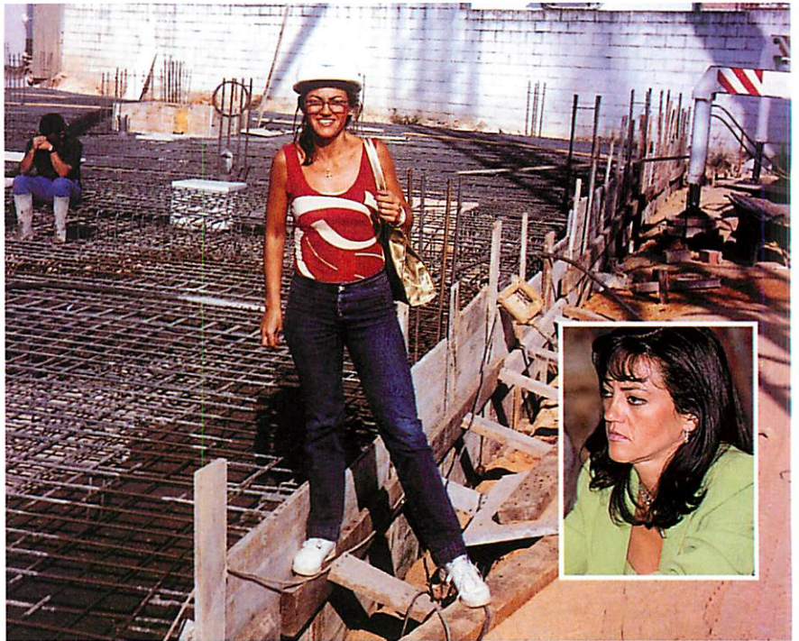
Gloria Sendra en la obra que está dirigiendo en Dos Hermanas (Sevilla).
