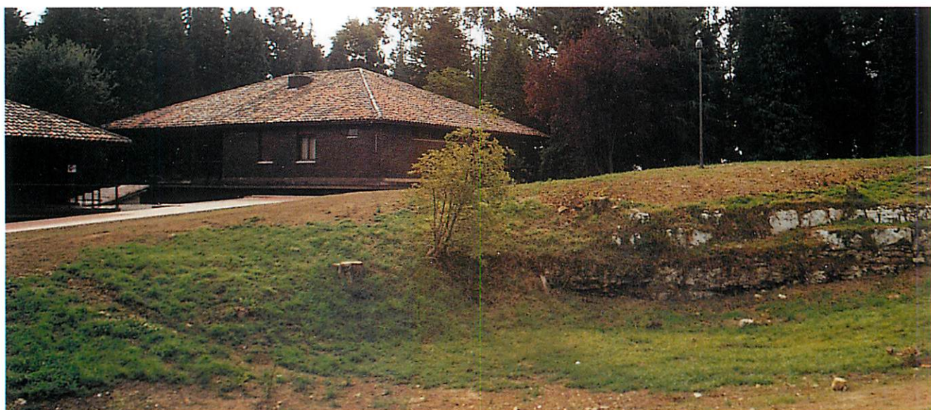
68 Vista de la zona del pabellón después de concluir los trabajos de demolición.
