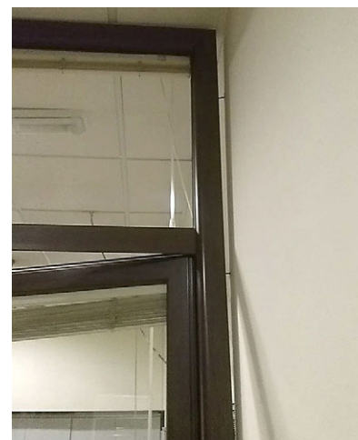
Fig. 9: encuentro entre carpintería y una pared dejando una holgura excesiva entre ambos elementos.
