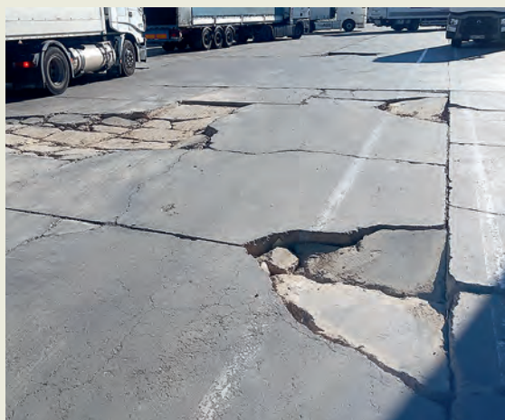
Lesiones en solera exterior industrial. Fuente: archivo Geosec.
