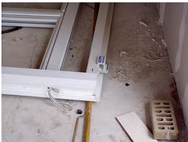
Fig. 9: ventana mal acopiada y situada en el suelo sin cuidado, antes del proceso de su fijación en la fábrica de fachada.
