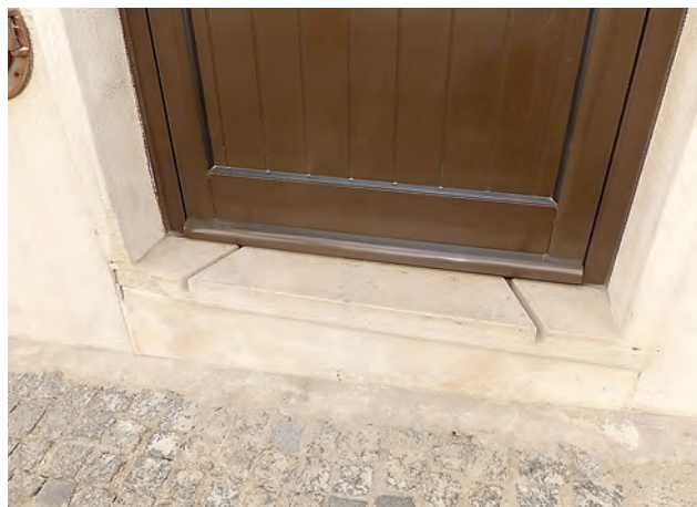
Fig. 7: acanaladura en un umbral en una vivienda de construcción tradicional de Portugal.
